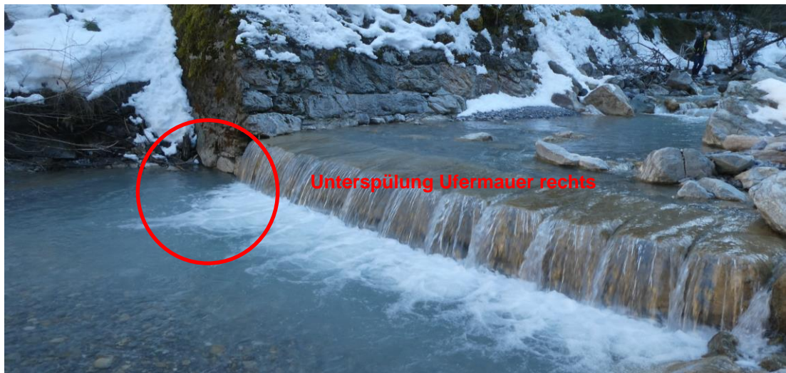
Abbildung 9: Schadenbild am oberen Schwellenbauwerk, März 2020
